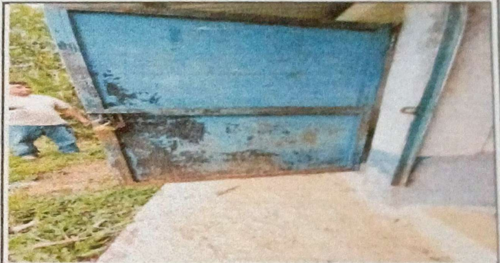
Foto 4: Se observa que las puertas de los baños estan en malas condiciones por su antigüedad
