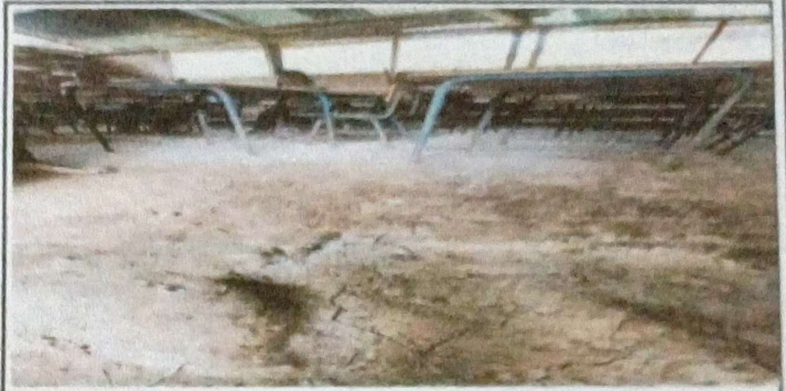
Foto 2: Se puede observar que el piso esta en mal estado en todas las aulas.
