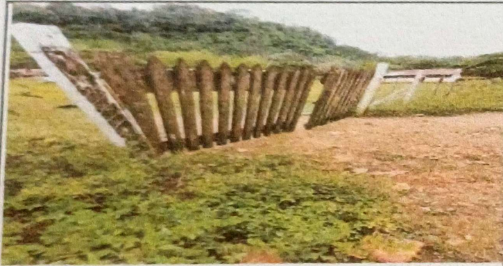
Foto 3: Se observa que el portón de ingreso principal al establecimiento esta en mal estado.
