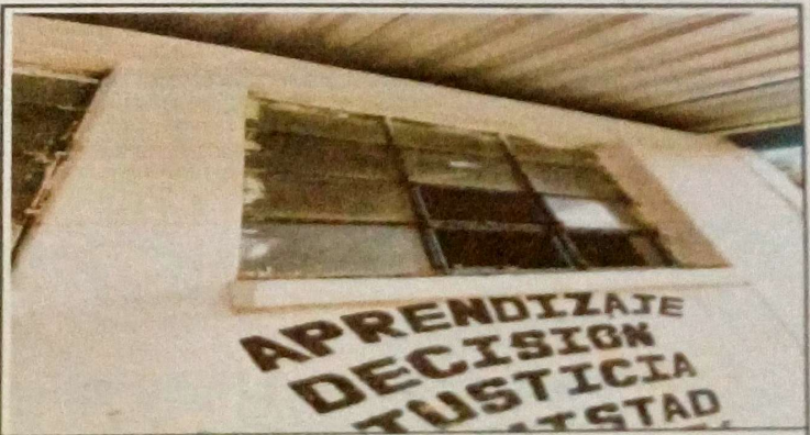
Foto 6: Se puede observar que hace falta balcón a la direccion de la escuela.
