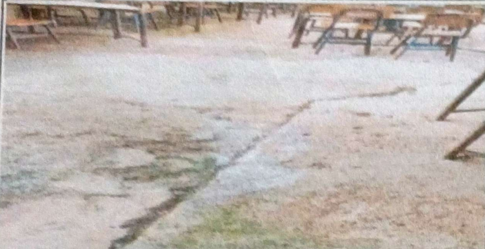
Foto 1: Se observa el deterioro del piso de las aulas, en tiempo de lluvia se humedese
